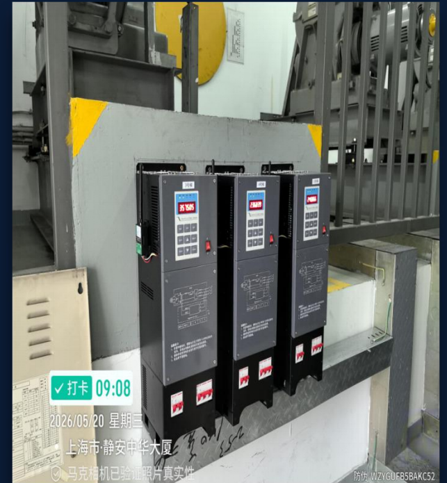
海之生设备在静安中华大厦的安装实例
